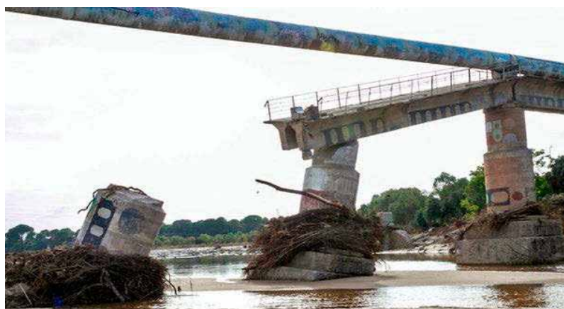
Efecto de la DANA en la tubería de Picadas.
